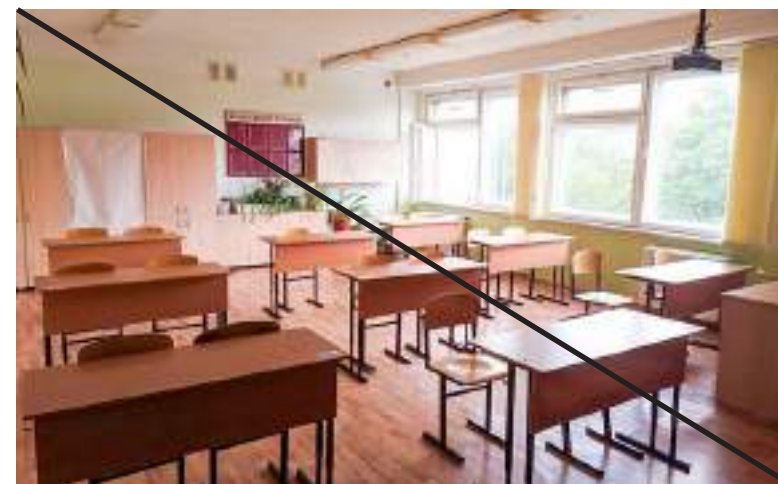
Плохо Линолеум под дерево
